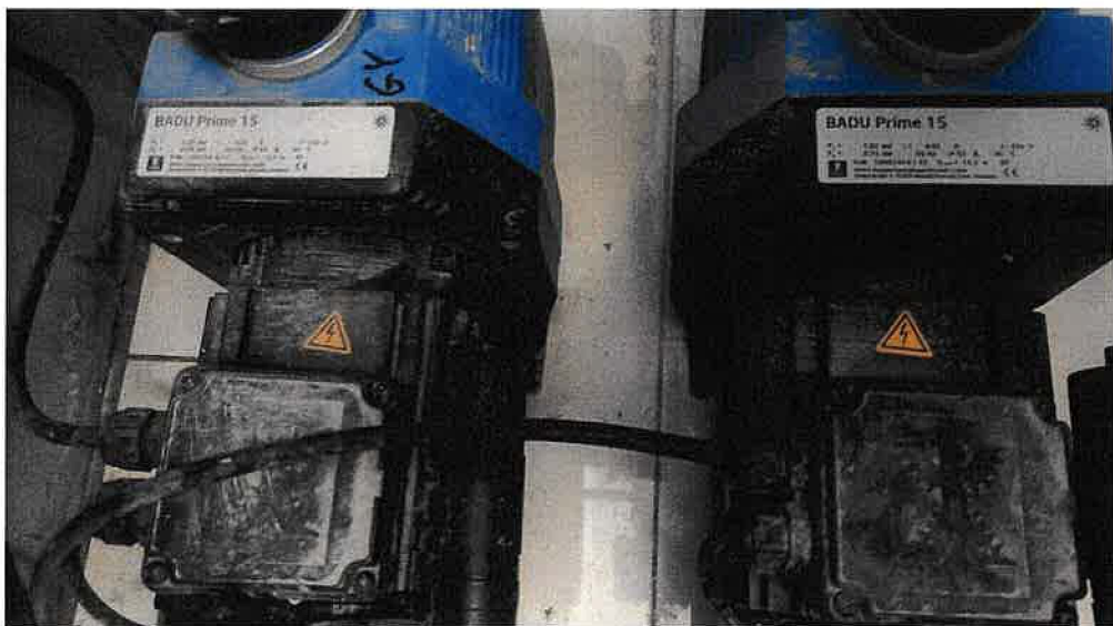
BADU Prime 15 vízforgató szivattyú.
