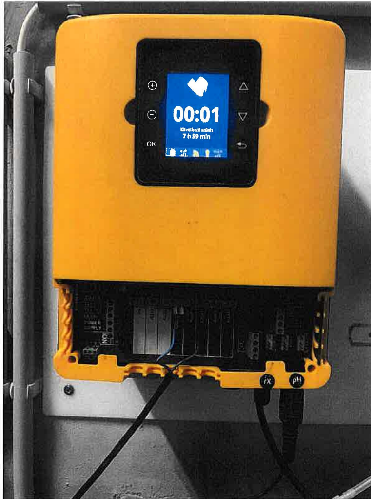
Automata vegyszeradagoló vezérlés – Sugarvalley Station.
