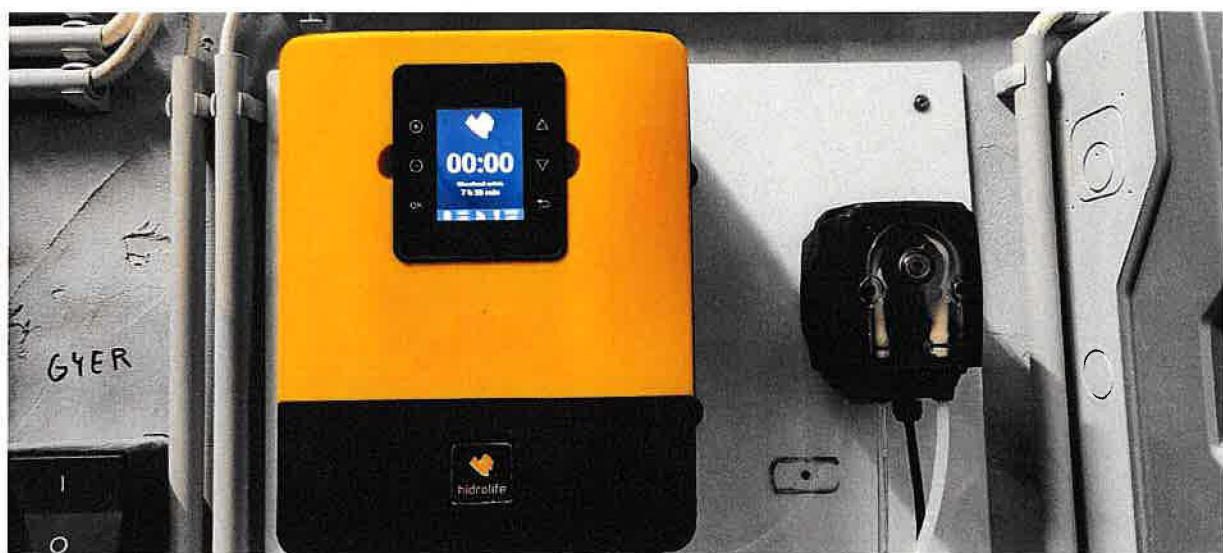
Automata vegyszeradagoló Stenner Econ 20VXH vezérléssel.
